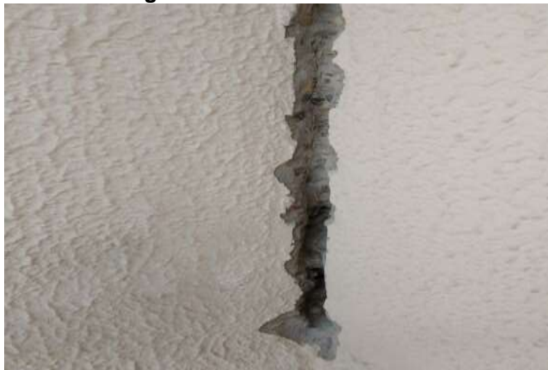
Figura 9 – Abertura de Fissura.
