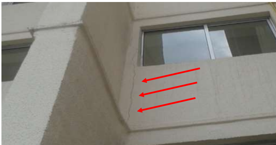
Figura 4 – Fissura em Parede Externa a 90°.
