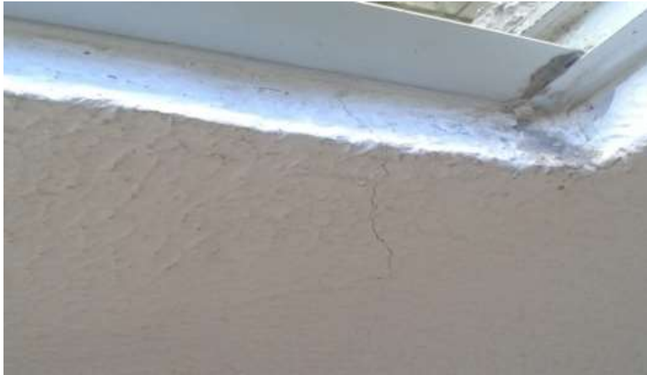
Figura 1 – Fissura em Esquadria a 45°.
